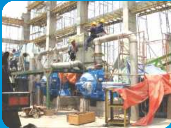
PIPE SUS & PUMP
